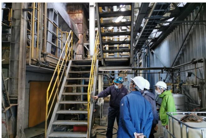
焼却溶融炉ロータリーキルン
