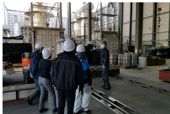
低濃度 PCB 廃棄物専用固定床炉
